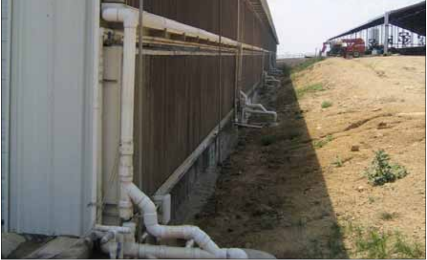
Bild 8. Genom att luftintaget sker genom så kallade "cooling pads" med strömmande vatten kyls ventilationsluften ner.
