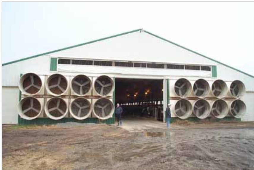
Bild 3. Tunnelventilation har en bättre kylande effekt än vanliga fläktar men nackdelen är en stor elförbrukning. På denna bild är det vinter och gardinerna längs husets långsidor är öppna. Under vintern fläktas huset med naturlig ventilation, eventuellt med några hjälpande cirkulationsfläktar (Foto: Delaval AB).
